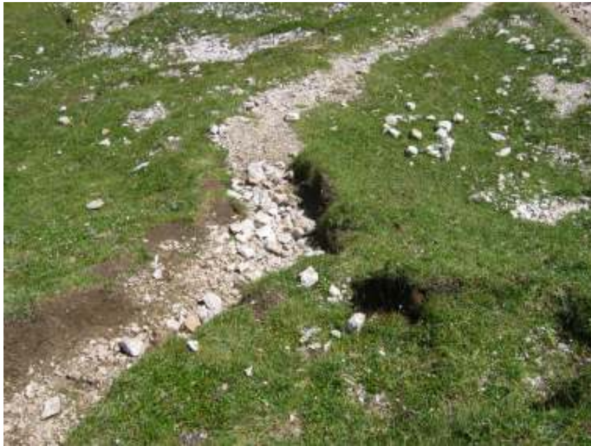
Abbildung 4: Zu sanierender Weg mit teilweise grobblockigem Schutt. (Foto: C. Keusch)
